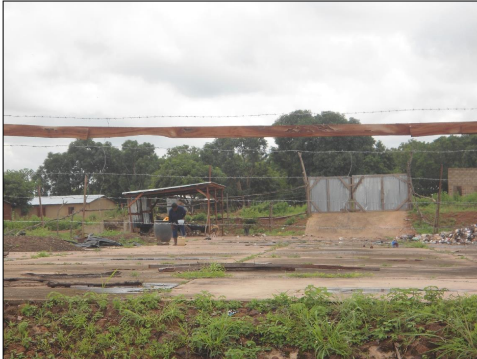
Plate forme pour sécher les boues de vidange traitées et pour faire le compost.
