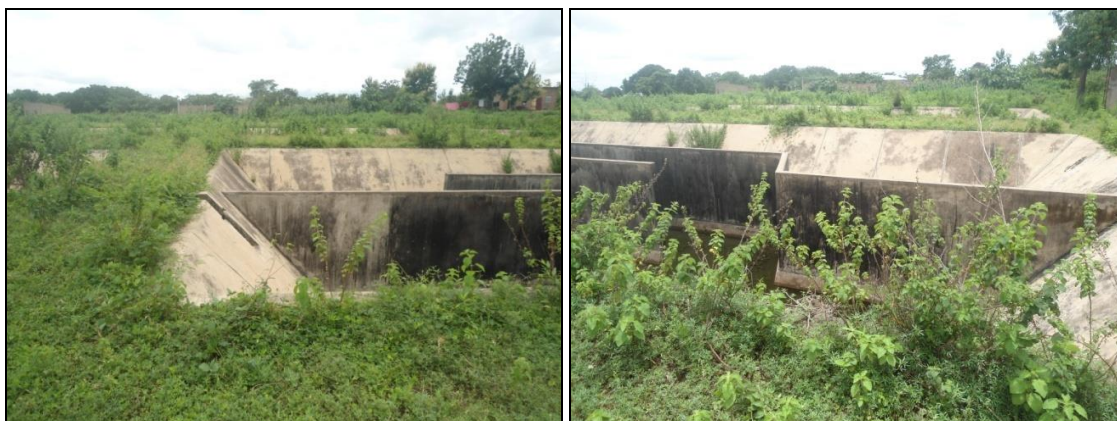
Station de traitement des boues de vidange de la ville de Parakou
